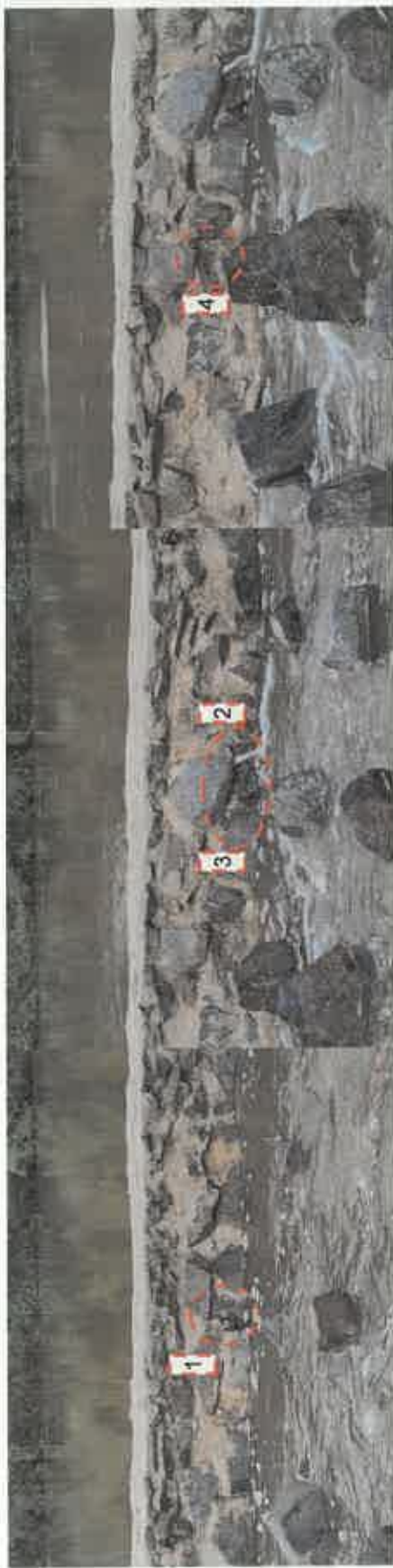
Fuites du mur (d'aval en amont)
